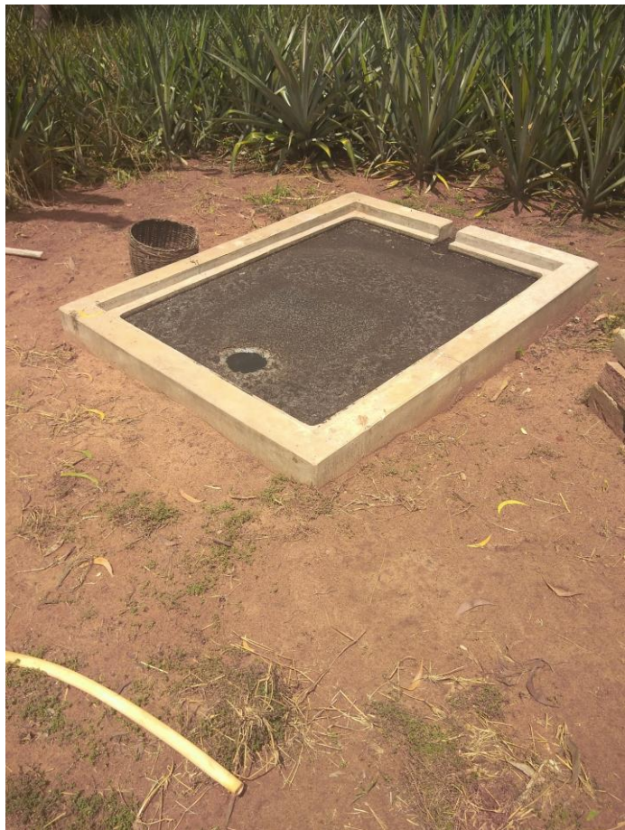
Décanteur des déchets
