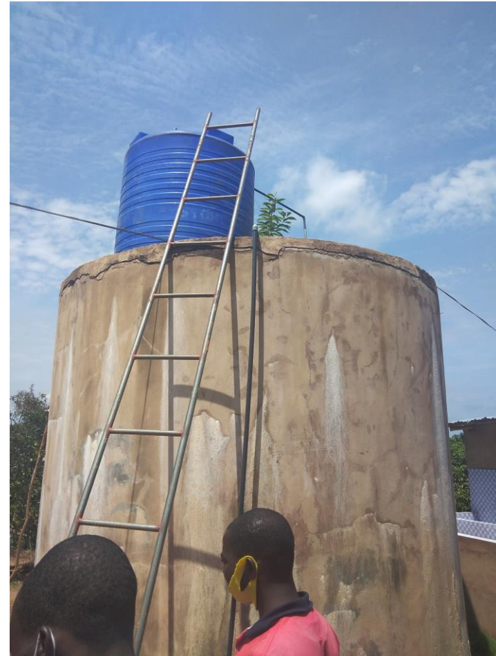
Citerne de stockage
