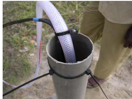
b : la pompe restée bloquée dans un des piézomètres
